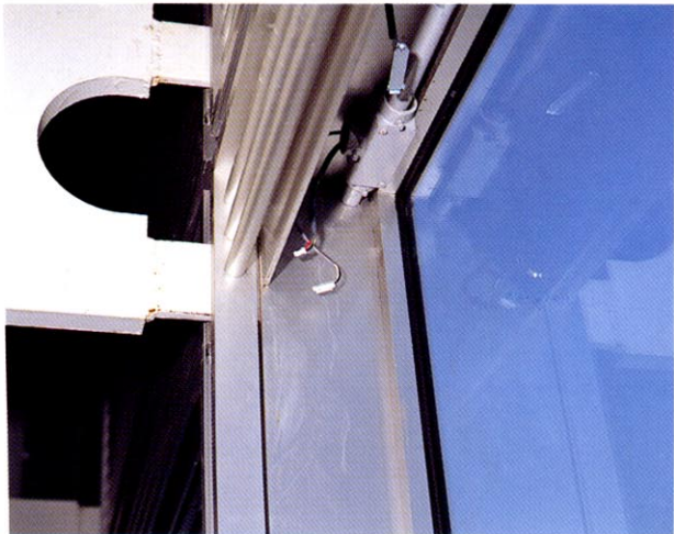
④ 配管部のコネクターと本体部のコネクターの結線部分
